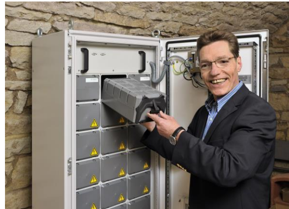
Lithium-Batterie als Energiespeicher
